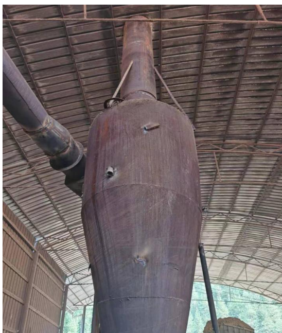
旋风除尘器现状
