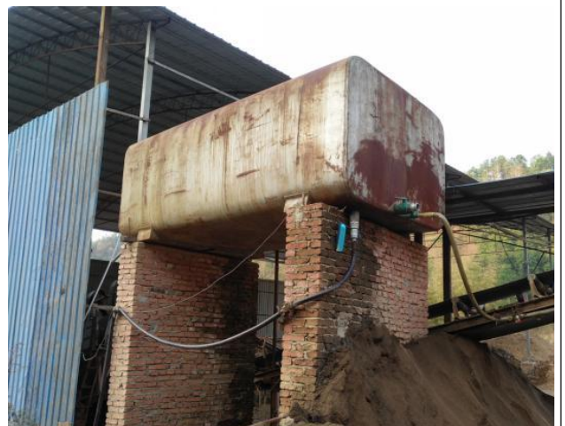
洒水降尘设施
