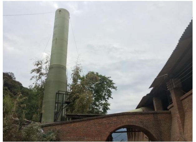
一体式除尘脱硫塔
