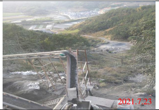
现有破碎站喷淋装置
